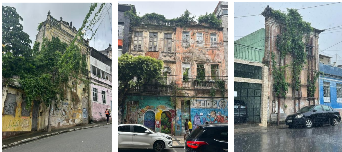
Figura 29,30 e 31 - Casarões com risco de desprendimento de elementos da fachada.
