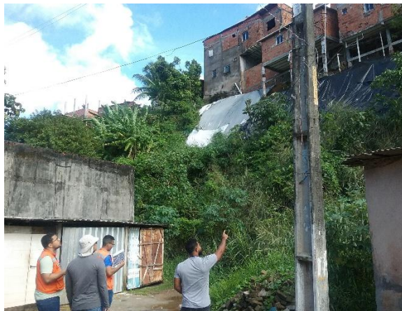
Figura 09 - Casa localizada na crista da encosta, em situação de instabilidade devido ao deslizamento de terra, poligonal Calabetão 2.
