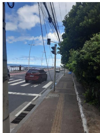
Figura 37 - Fiação solta. Ao longo do trecho
