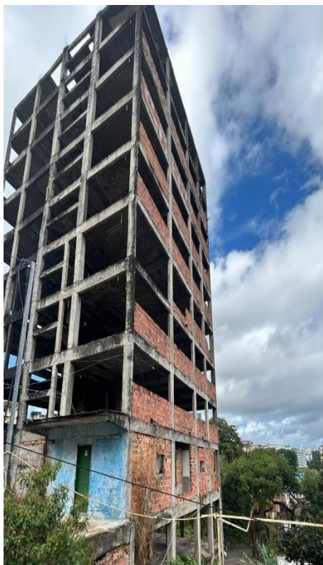
Figura 17- Imóvel Inacabado no Barbalho
