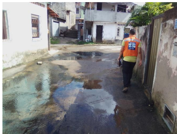
Figura 11 Técnico avaliando vazamento de tubulação de esgotamento sanitário da EMBASA, poligonal KM 17.
