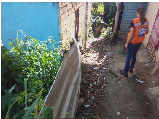
Figura 12 - Acesso danificado, devido ao escoamento concentrado de águas pluviais, localizado na poligonal Gamboa.
