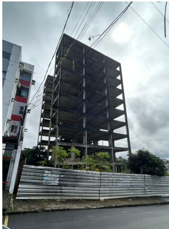
Figura 18 - Imóvel Inacabado na Federação
