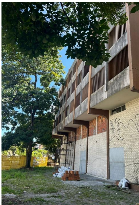
Figura 21 - Imóvel em desuso na Av. Vasco da Gama
