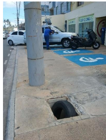
Figura 34 - Caixa sem tampa
