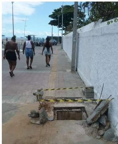
Figura 32 - Caixa de hidrômetro sem tampa.
