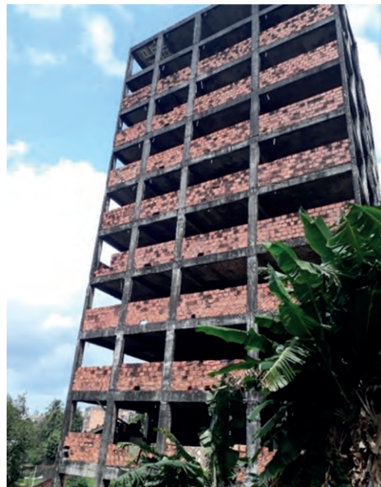
Figura 14. Imóvel inacabado. Foto: CODESAL
