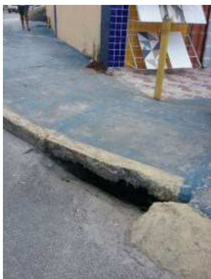
Figura 41: Bueiro sem grade de proteção.
