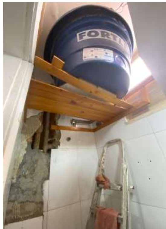
Figura 18: Não conformidade nas instalações hidrossanitárias.
