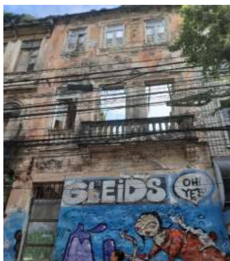
Figura 37: Risco de desprendimento de elementos da fachada de casarão.
