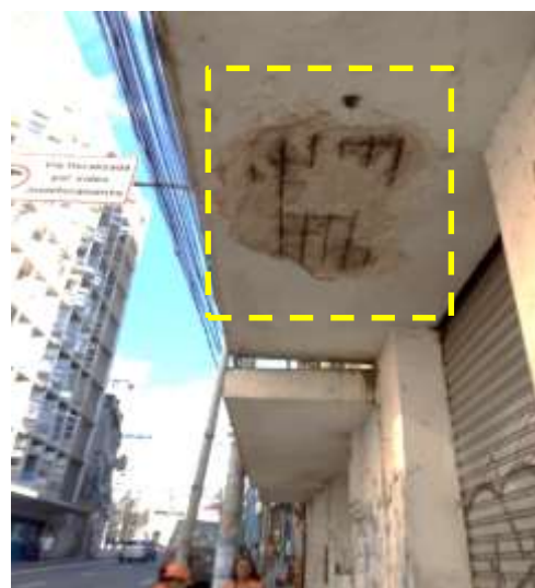
Figura 38: Corrosão de armaduras e risco de desprendimento de concreto.
