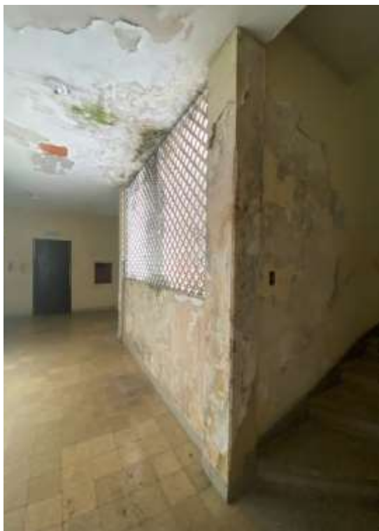
Figura 19: infiltrações generalizadas, oxidação de armaduras e descascamento de pintura.
