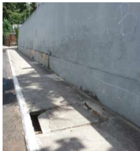
Figura 46: Caixa com tampa danificada.
