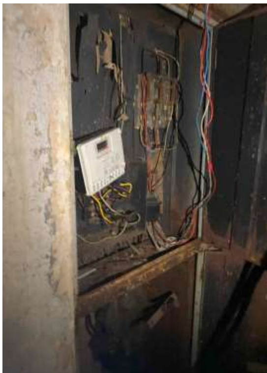
Figura 15: Fiações expostas e falta de manutenção.
