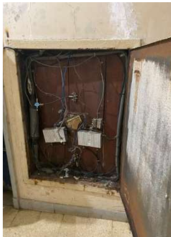
Figura 16: Quadro de telefonia em condições precárias.
