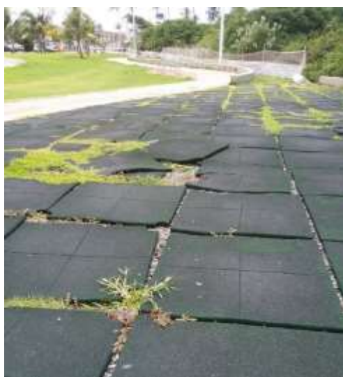
Figura 57: Revestimento do piso danificado.
