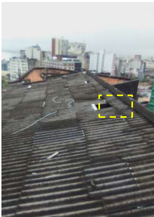
Figura 23: Falhas na cobertura.
