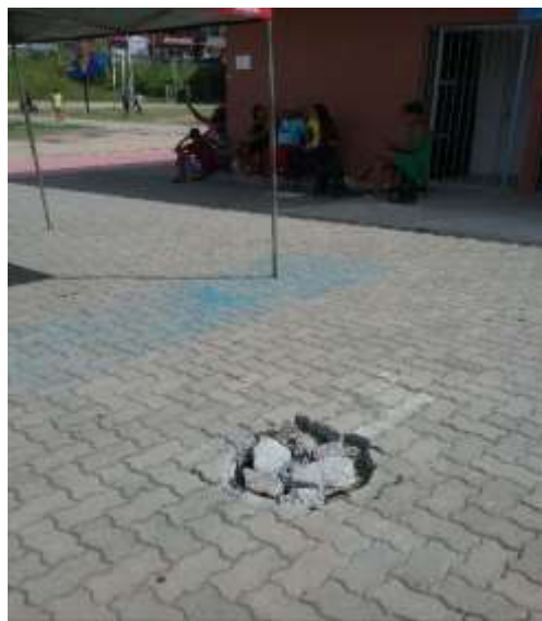
Figura 44: Piso intertravado danificado.
