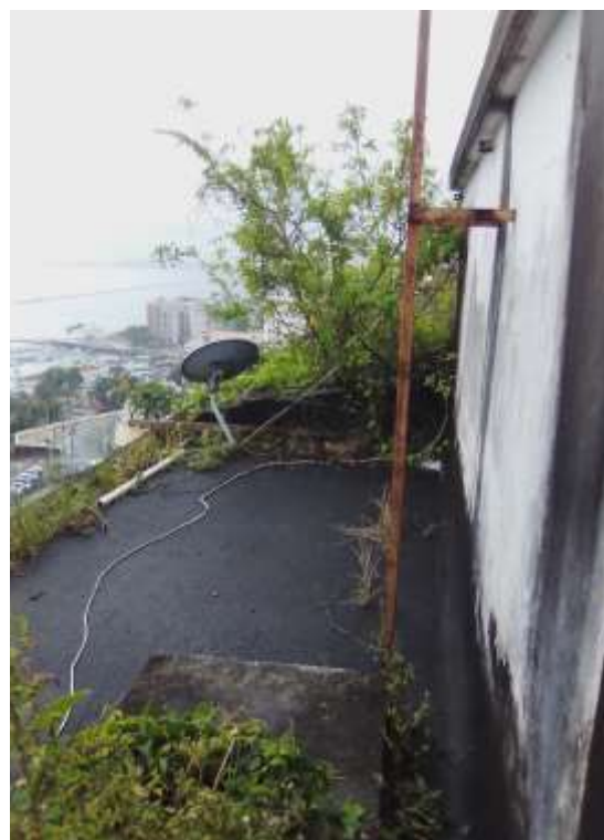
Figura 22: Vegetação enraizada na cobertura.
