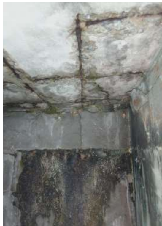
Figura 24: Corrosão de armaduras na casa de máquinas.
