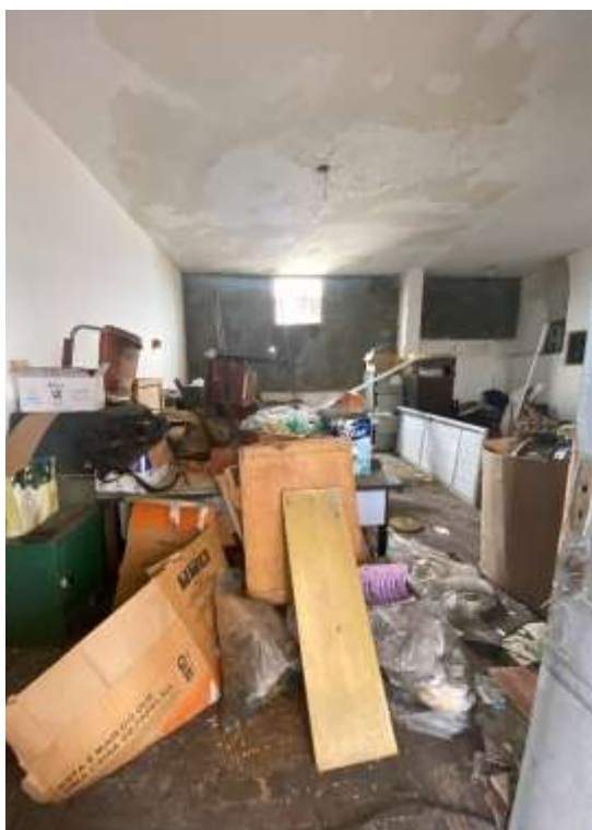
Figura 21: Acúmulo de materiais no último pavimento
