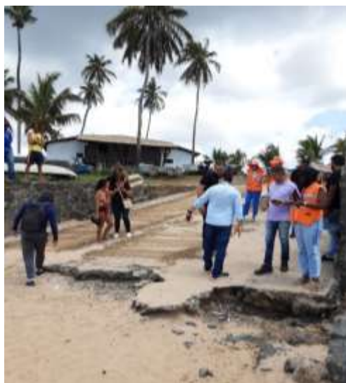
Figura 55: Desnível na rampa de acesso à praia.
