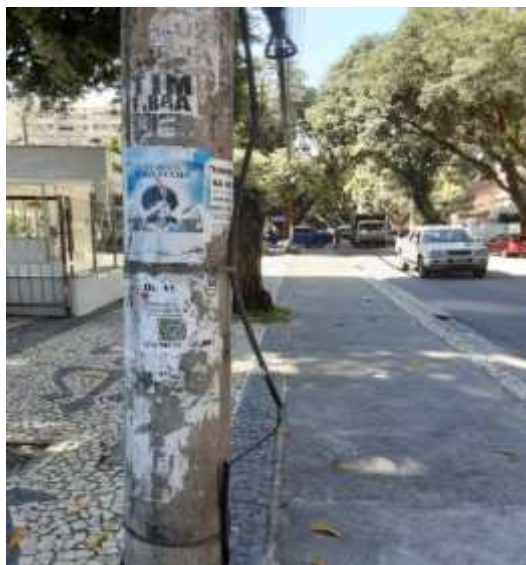
Figura 49: Eletroduto danificado (fiação exposta).
