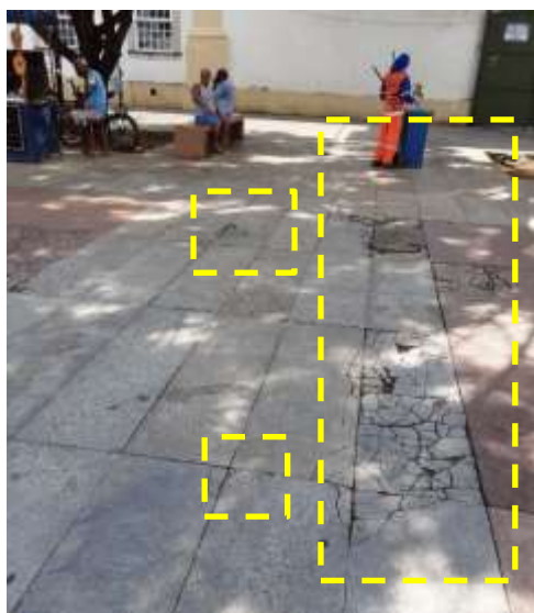
Figura 33: Calçada em granito danificada.
