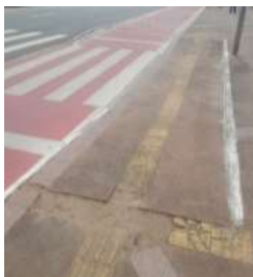
Figura 51: Piso tátil danificado.
