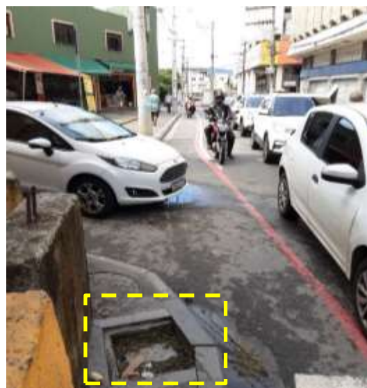
Figura 34: Calçada em granito danificada.
