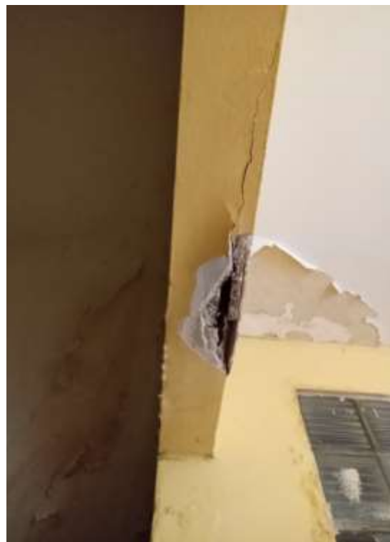
Figura 20: Corrosão de armaduras.
