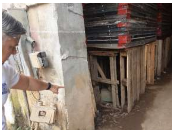
Figura 6: Técnico indicando o local onde a água atingiu no último alagamento.
