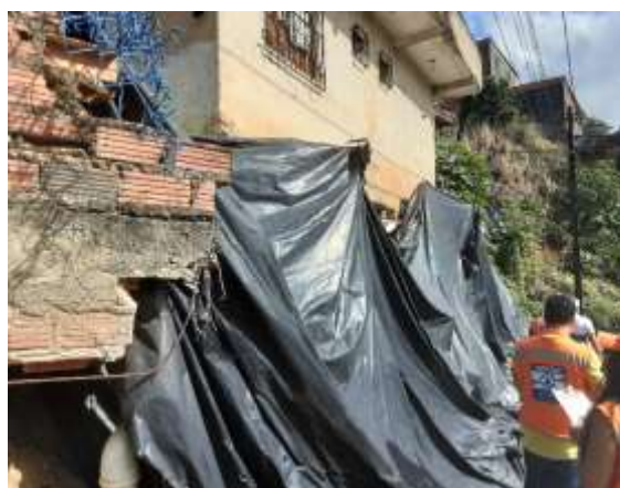
Figura 4: Casa localizada na crista da encosta, em situação de instabilidade devido ao deslizamento de terra.
