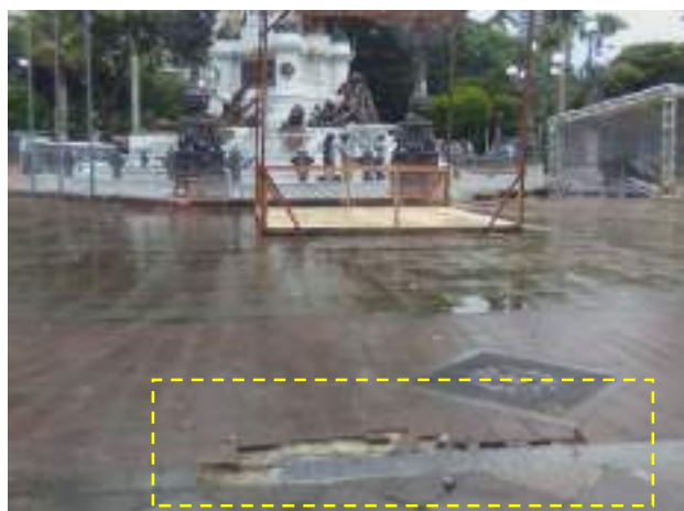
Piso em granito danificado.
