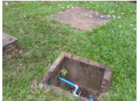
Caixa de ponto de irrigação sem tampa.
