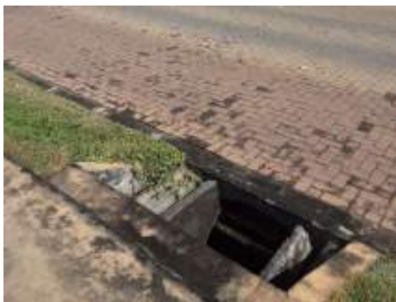
Caixa de drenagem sem tampa.
