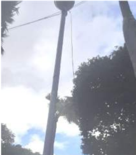
Fiação de energia solta.
