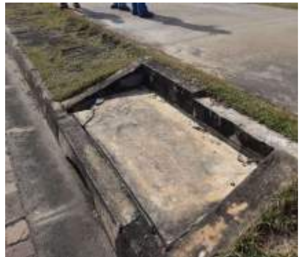
Caixa de drenagem com tampa danificada.
