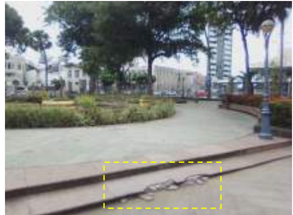
Piso em granito danificado.
