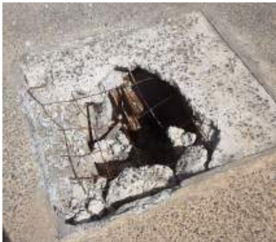
Tampa de concreto danificada.
