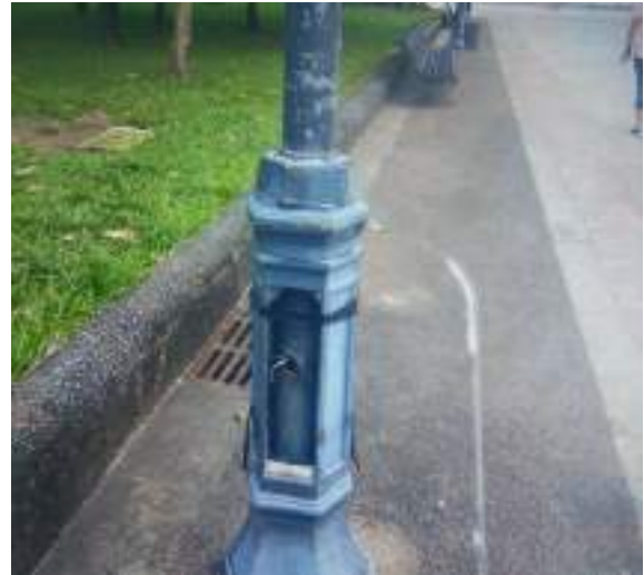
Poste com fiação exposta.
