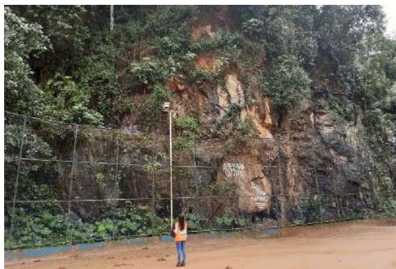
Pedreira com alto grau de fraturamento das rochas, podendo ocorrer desprendimentos de blocos rochosos.
