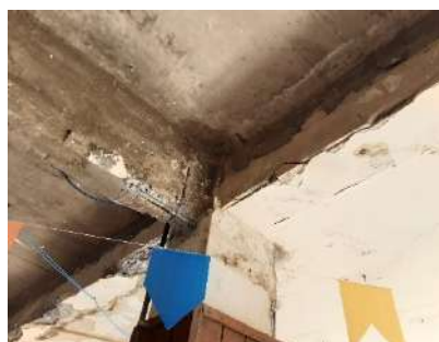
Corrosão de armaduras em viga.
