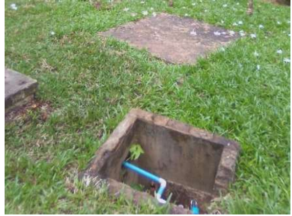
Caixa de ponto de irrigação sem tampa.
