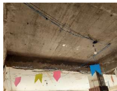
Corrosão de armaduras em viga.
