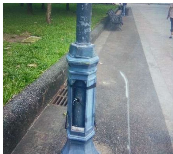
Poste com fiação exposta
