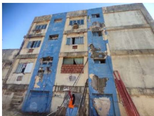
Vista da fachada com regiões de corrosão de armaduras.
