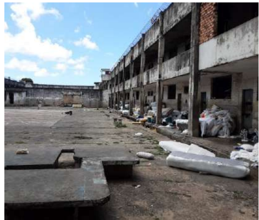
Vista do pátio – manchas na fachada e ambiente insalubre.
