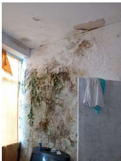
Infiltração em unidade.
