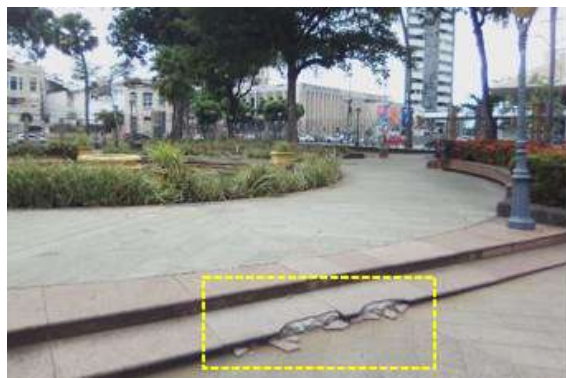
Piso em granito danificado
