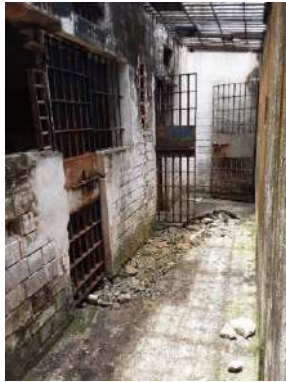
Portões e grades em estado avançado de oxidação.
