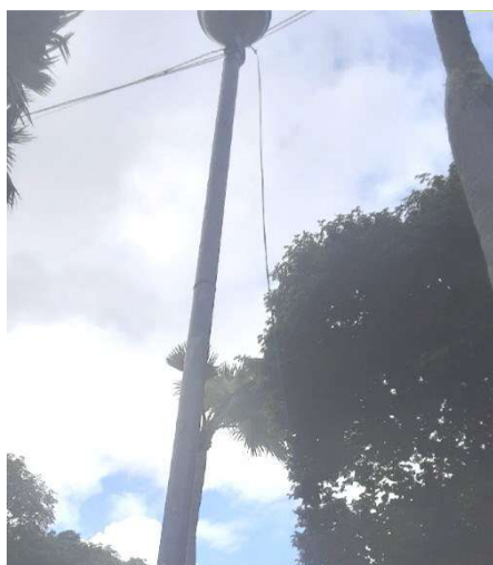
Fiação de energia solta
