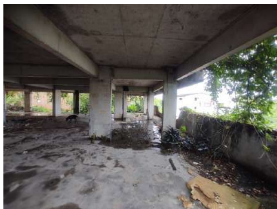
Água acumulada no piso.
