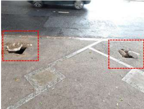
Caixas vazias com tampa danificada
