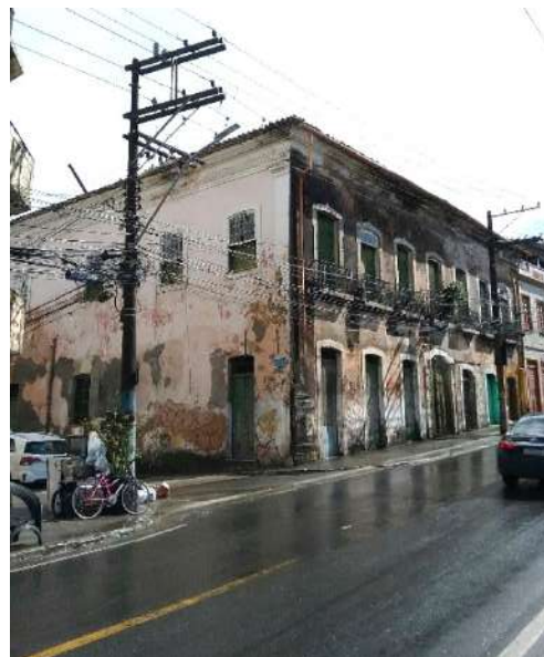
Solar Bandeira Vistoriado em Fevereiro 2023
