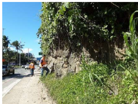
Encosta com rochas bastante fraturadas, podendo ocorrer desprendimentos de blocos rochosos.
