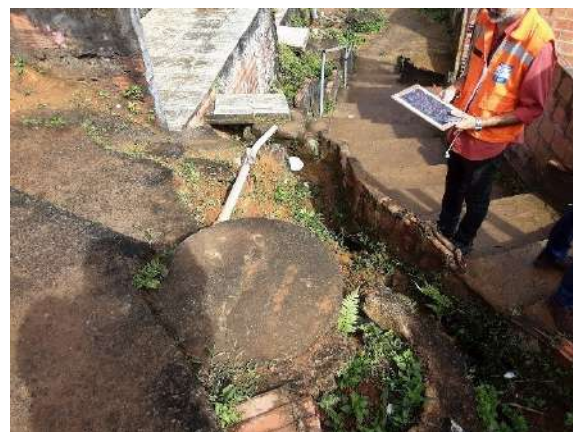
Escoamento concentrado de águas pluviais causando ravinamento na lateral da escadaria.
