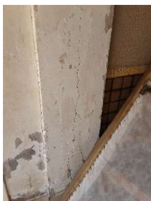
Fissura indicativa de corrosão de armaduras.
