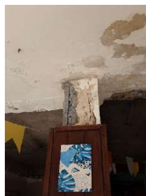
Corrosão de armaduras em pilar.
