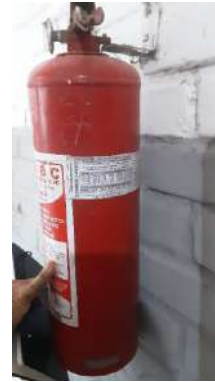
Extintores com prazo de manutenção vencido.
