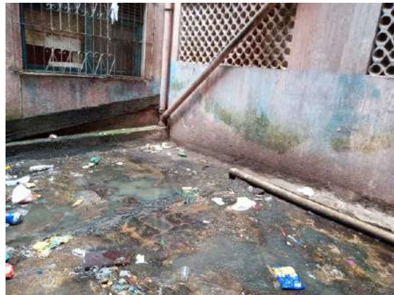
Lixo acumulado e lançamento de esgoto no pátio.
