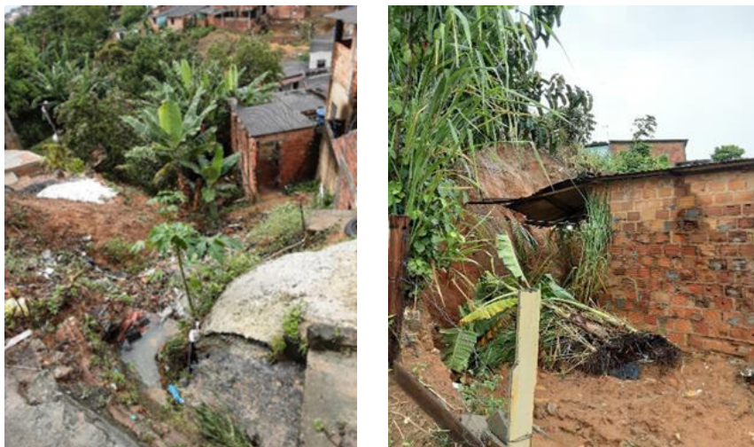
Figura 09 – Deslizamento de terra na comunidade de Mamede em 08/04/2021.
