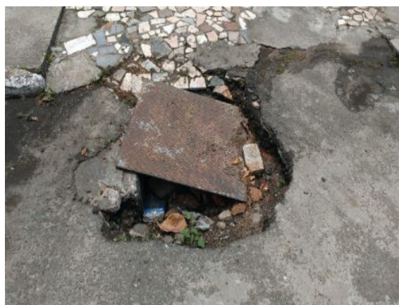
Cabula/Planalto (Rua Clovis Amorim) – fuga de material na caixa da rede pluvial (caixa obstruída).
