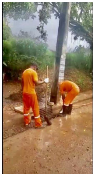
Palestina (Rua Sargento Bonifácio) – monitoramento de alagamento
