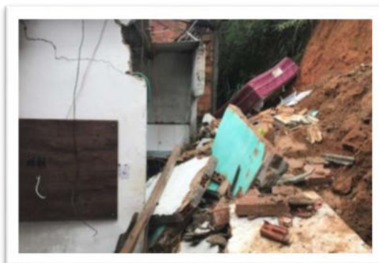
Vistoria na regional, verificando os impactos das chuvas.
