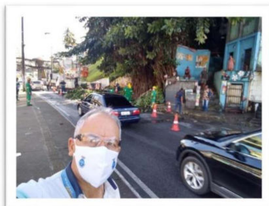
Remoção de árvore que caiu devido as chuvas recorrentes.
