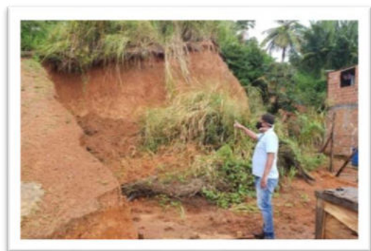
Subprefeito Alan Muniz vistoriando área com deslizamento de material.
