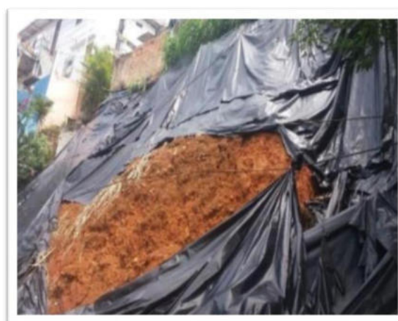
Vistoriando e pedindo recolocação de lona em área de risco de deslizamento
