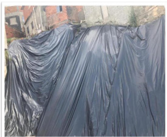
Risco de deslizamento, solução provisória
