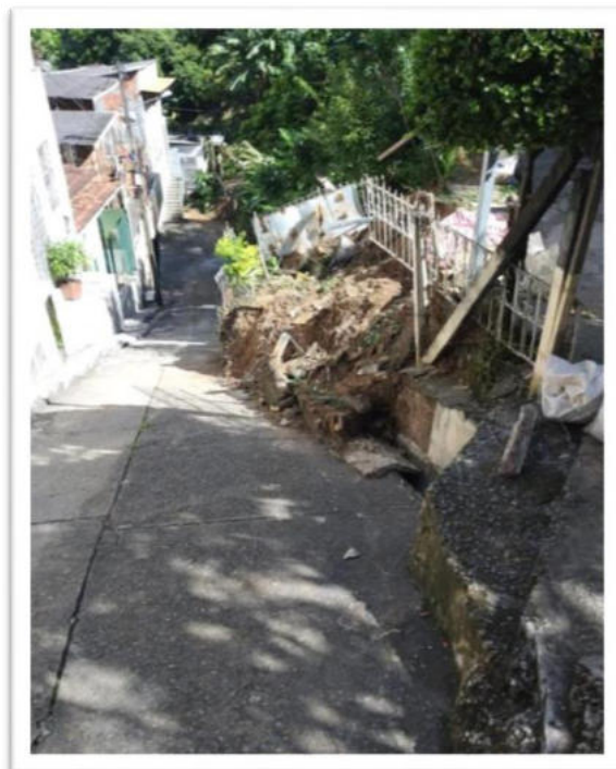
Vistoria em área com deslizamento
