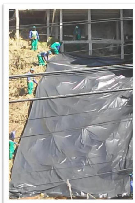
Medida provisória em área com risco de deslizamento
