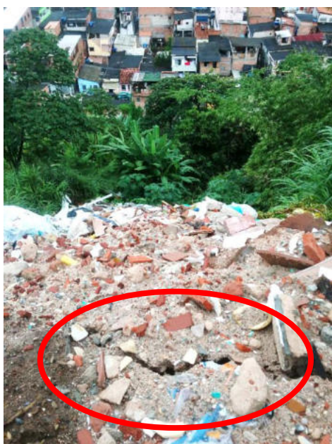
Figura 02 – Registro de rachadura em terreno, na Vila Picasso, em 07/05/2018.
