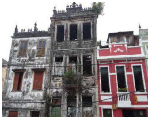
Fachada de casarão com risco de queda de revestimento/elementos decorativos
