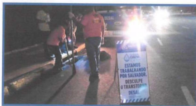
Avenida ACM - Pituba
