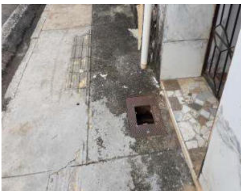
Caixa de hidrômetro na calçada sem tampa – Risco de queda
