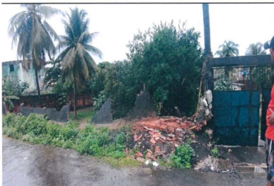
Paripe (Rua Granja) – vala obstruída/ desabamento de muro
