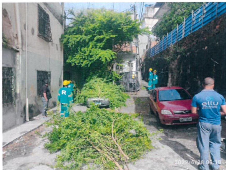
Fazenda Grande do Retiro (Vila São Roque) – poda de árvore com risco de queda
