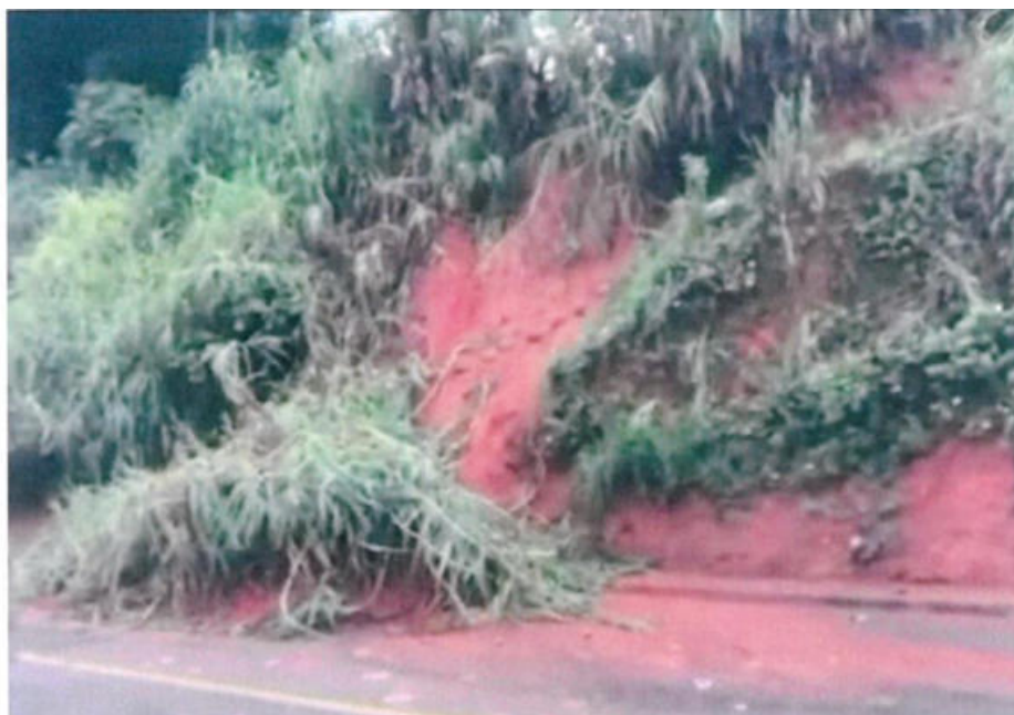
Periperi (Rua das Pedrinhas) – deslizamento de terra
