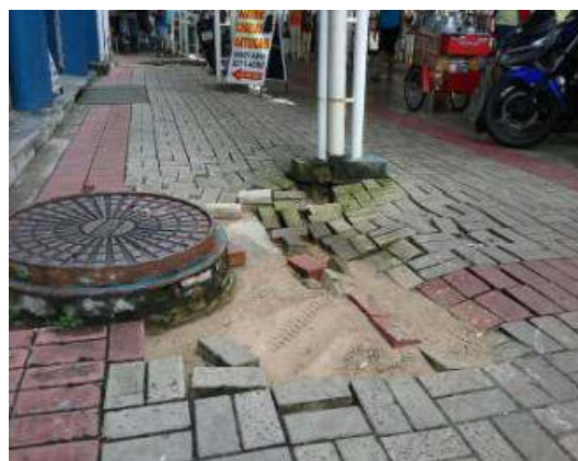
Calçada danificada – Risco de queda
